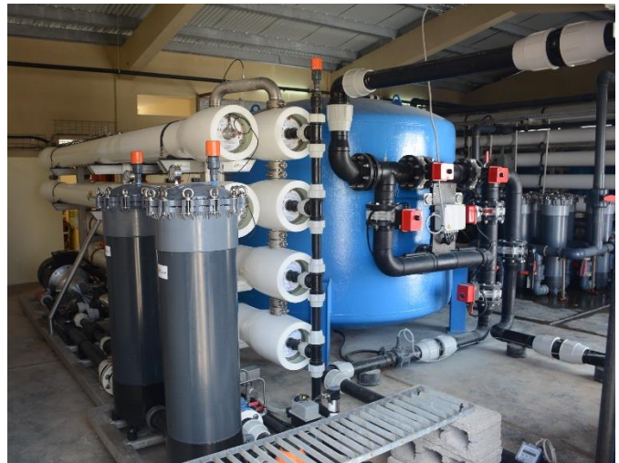
L'unité de dessalement Osmosun produira 80m 3 d'eau potable par jour à partir de l'énergie solaire et 300m 3 en alimentation hybride.
